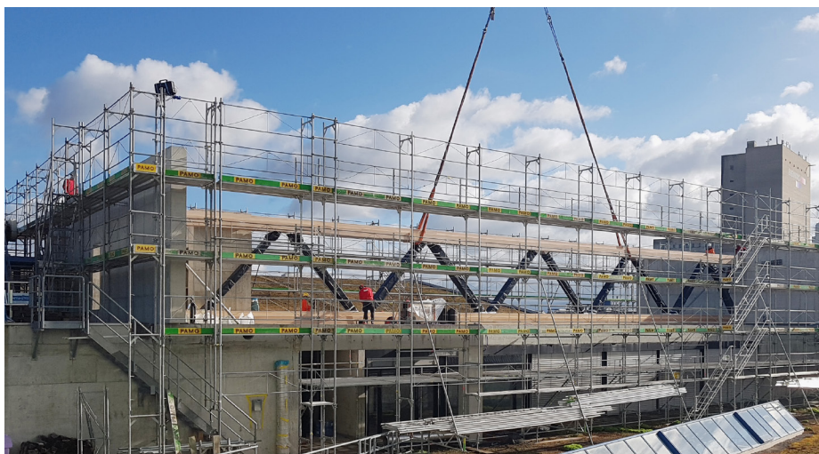
Auf den Millimeter genau wurde der vorgefertigte Fachwerkträger in die Betonaussparungen über dem bestehenden Bürogebäude eingefügt. Fotos: Fagus Suisse SA
